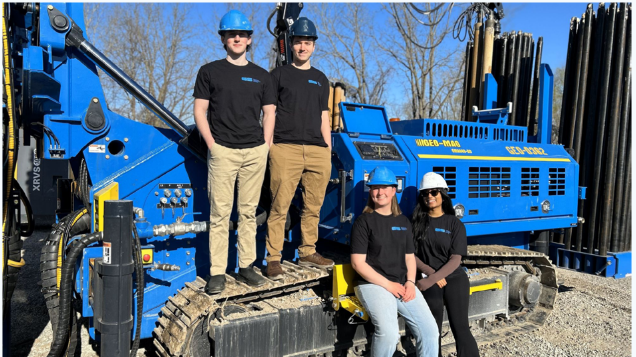
Photo fournie par l'Association géothermique de l'Ontario
